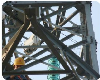
220KV高压电塔
