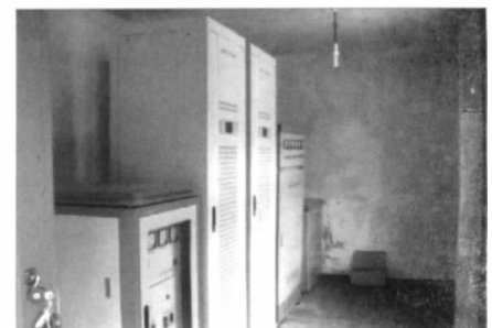
图6 光伏发电控制器
