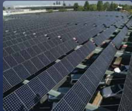
应用材料公司加州总部的太阳能发电系统输出近2兆瓦的清洁能源。
