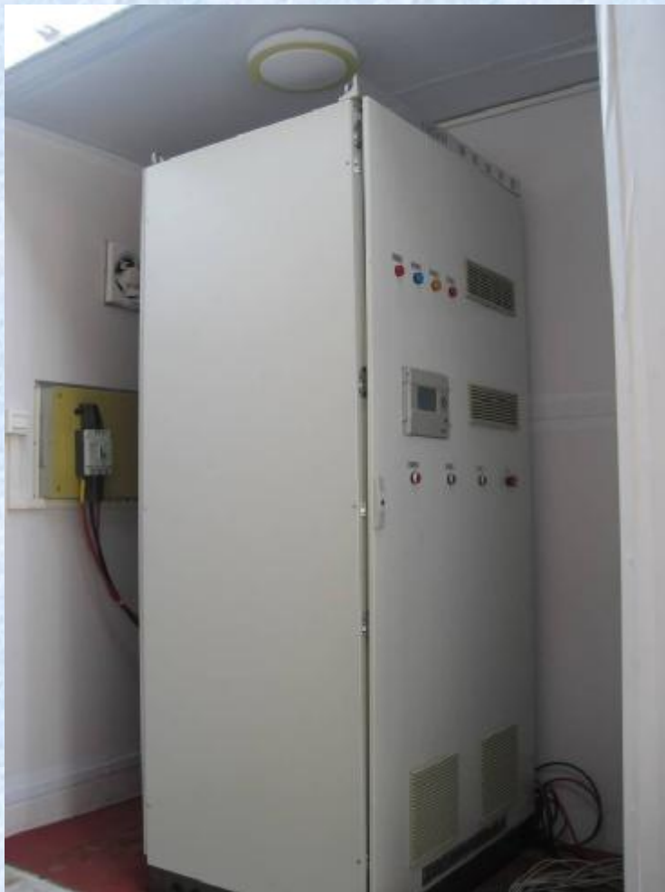
电池储能电站PCS(双向逆变器)图
