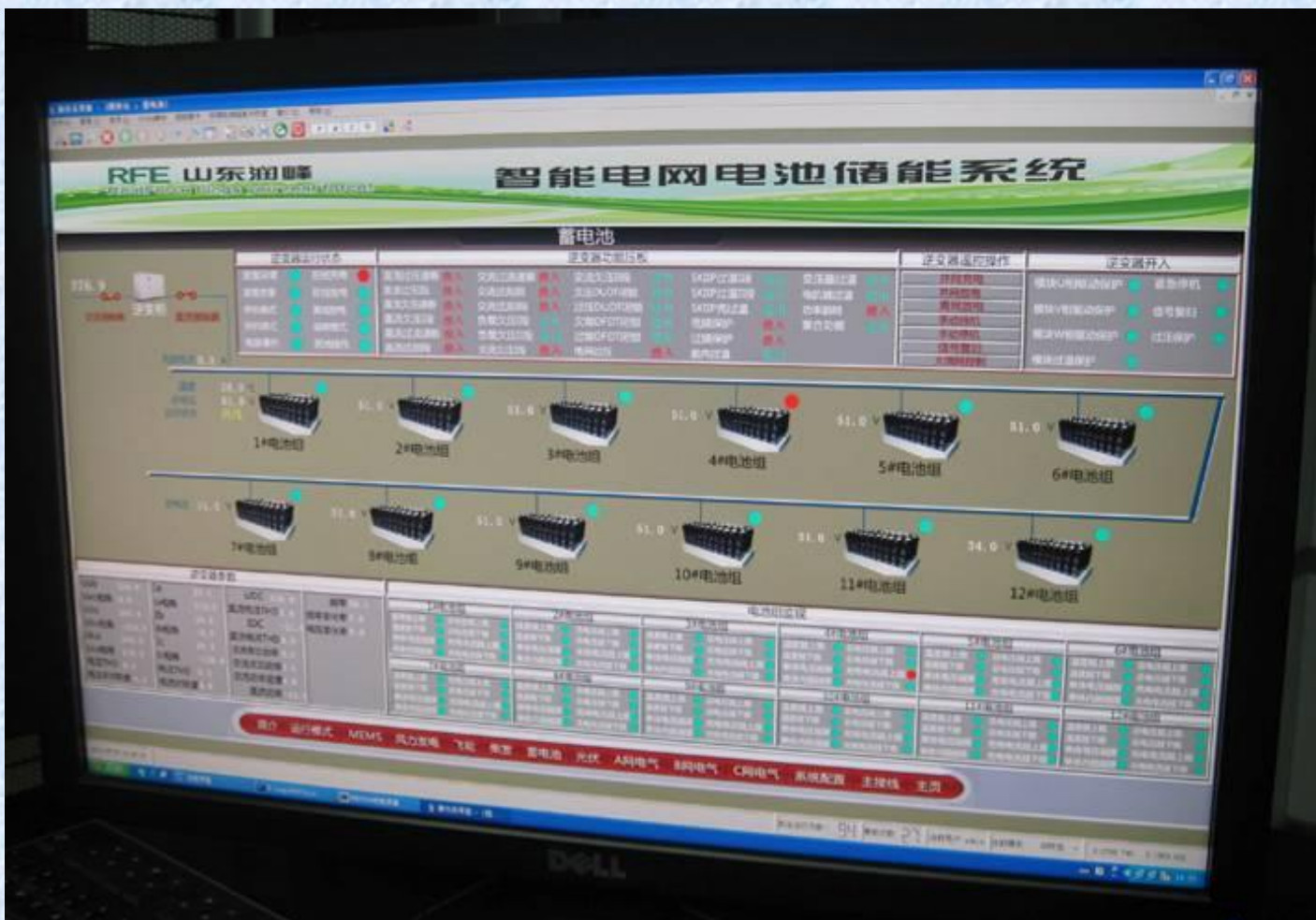
电池储能电站监控系统
