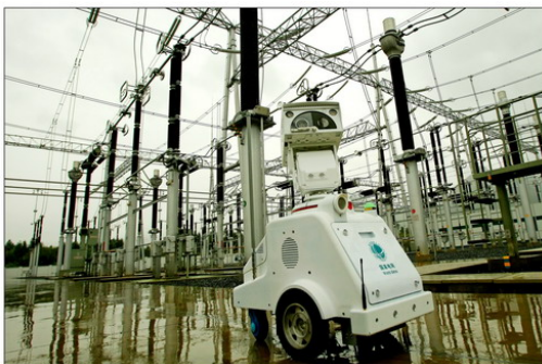
图 A1 变电站设备巡检机器人 Fig.A1 Substation inspection mobile robot
