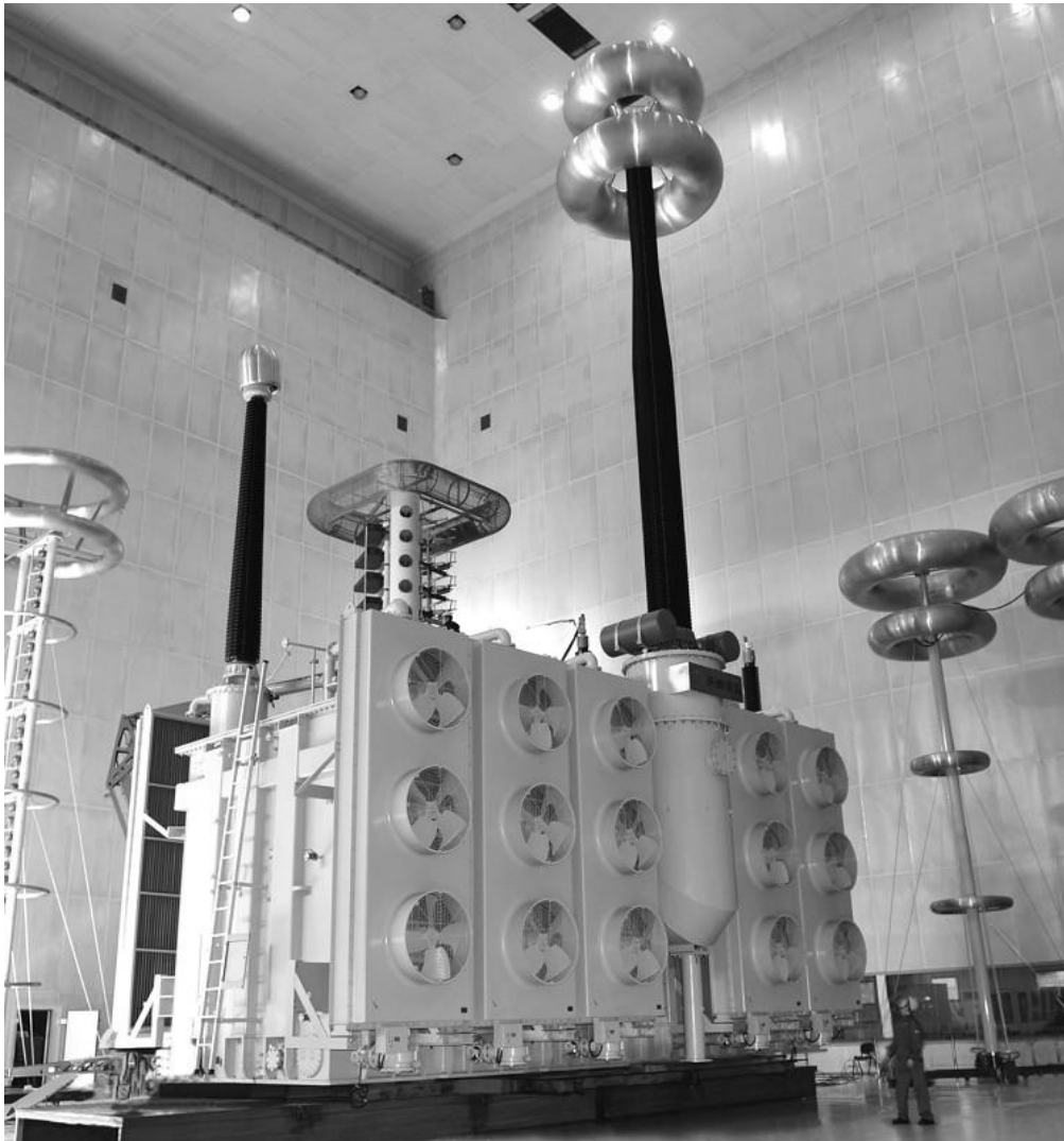
天威保变研制的世界最高电压、最大容量的 1500MVA1000KV 特高压变压器
