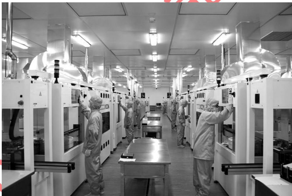
天威新能源控股公司电池生产线
