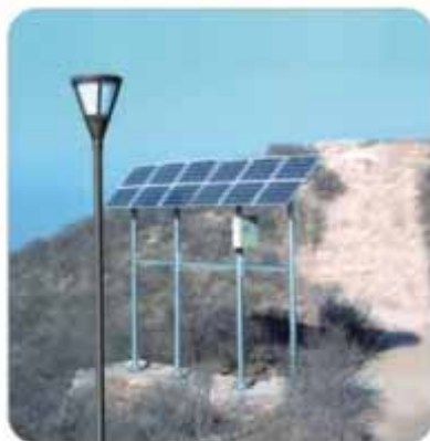
公园亮化供电系统 Park lighting power supply system
