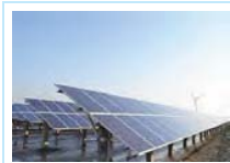
30天30MW 中海阳光光伏电
