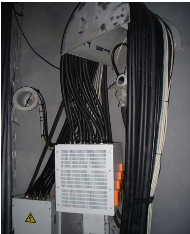
塔筒上部：发电机电 缆→BUS BAR
