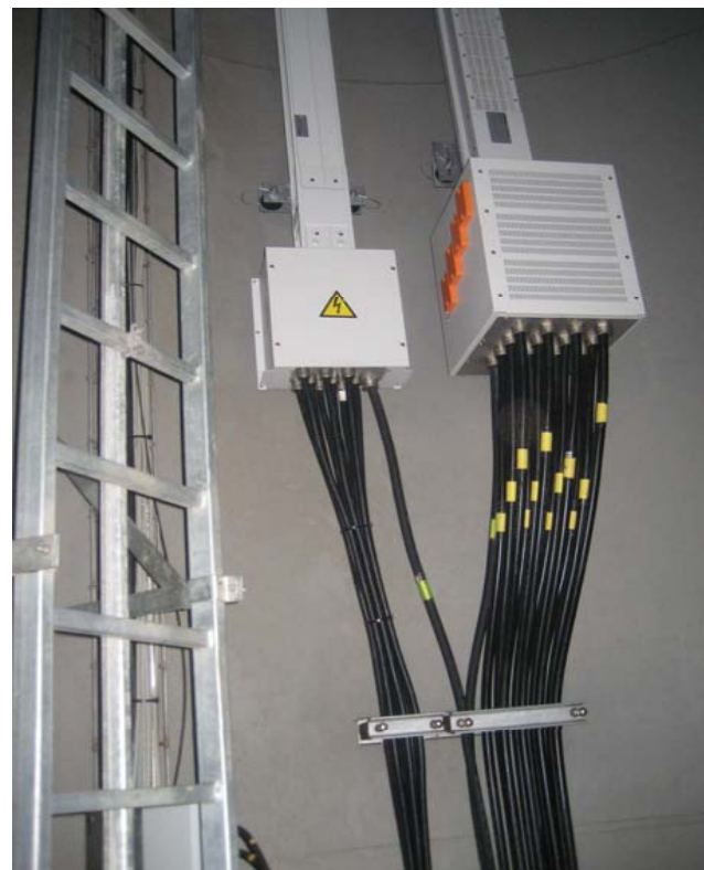
塔筒下部：BUS BAR→变频器
