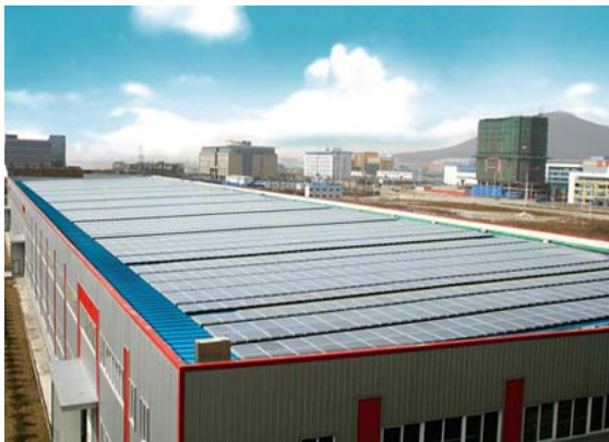
图1 合肥阳光产业基地 500KW 光伏发电系统
