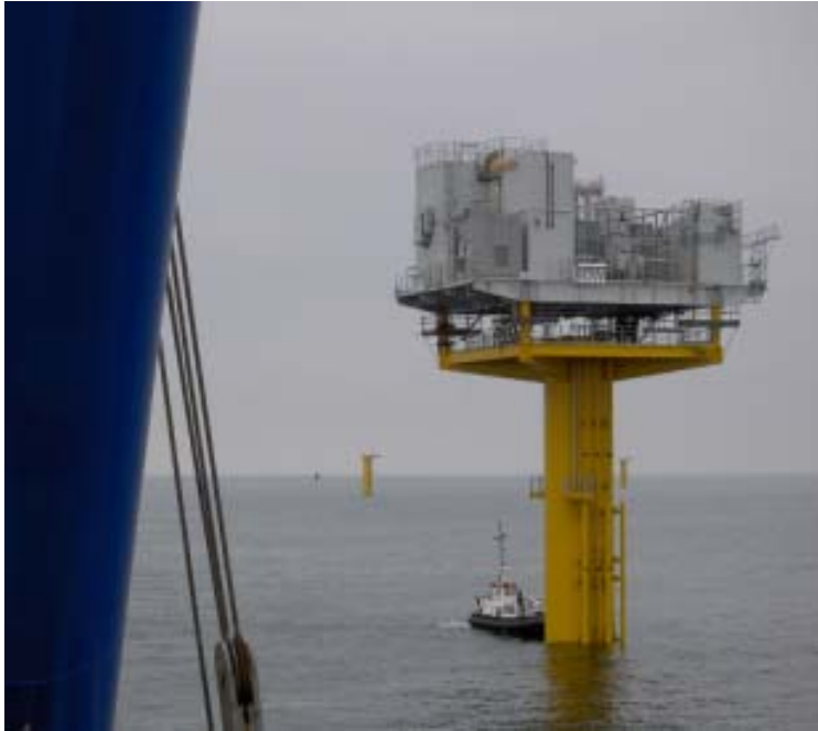
平板车式结构 Barrow (Installed)
