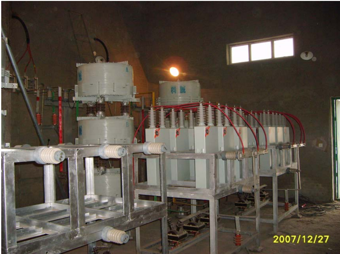
图 6 通顺铝厂四机组补偿装置
