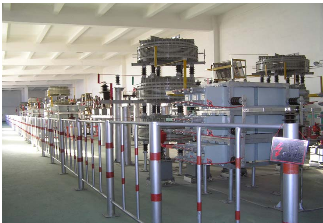
图5 通顺铝厂四机组补偿装置
