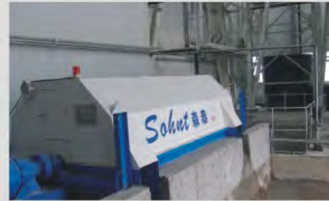
天津金隅 / Indoor Site
