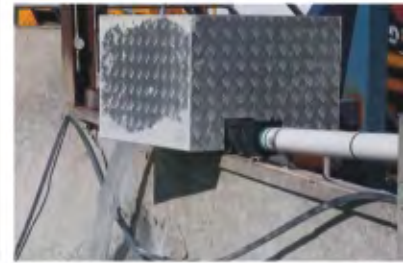
PH值控制系统 / PH Control System
