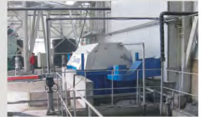
天津金隅 / Indoor Site
