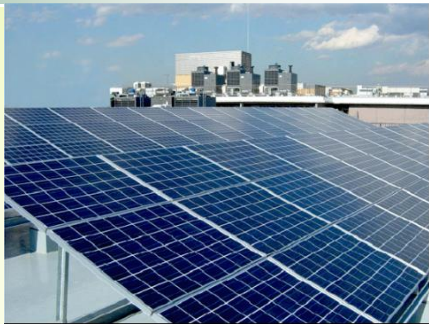
已经建设完成的光伏发电系统
