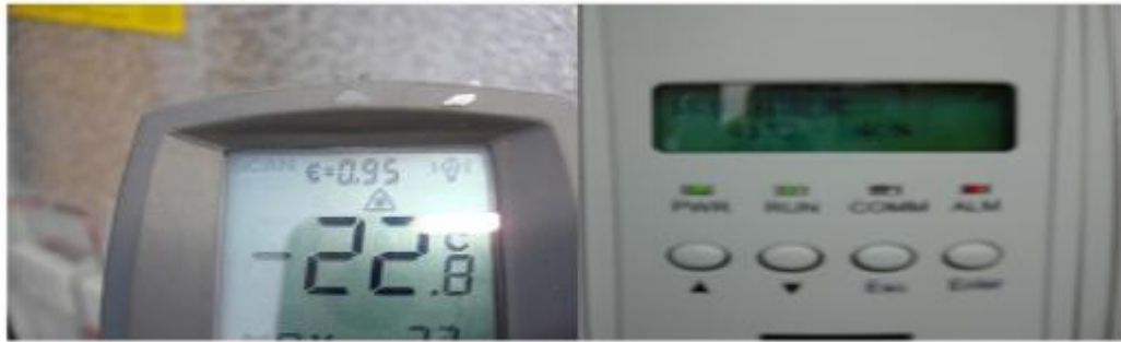
室外站电池柜冬季夏季实测温度
