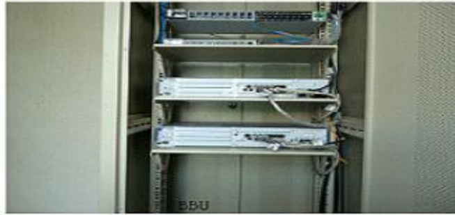
机房信源基站 BBU 图
