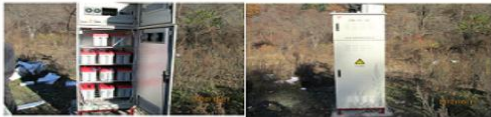
高压直流电源内部图
