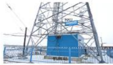
机房 RRU 基站图
